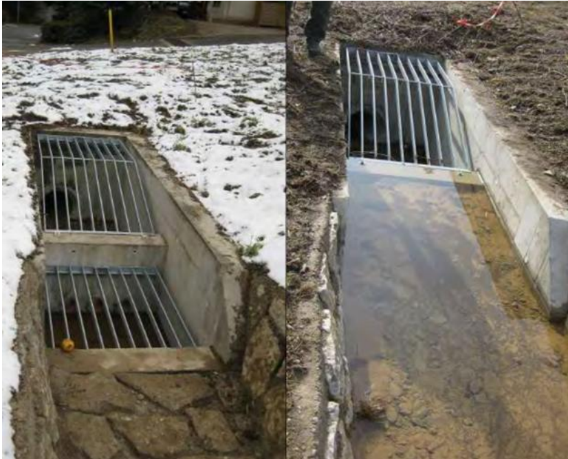
Abbildung 6: Einlaufbauwerk mit Schlamm- und Geröllfang vor und nach Starkregen (Stadt Buchen).
